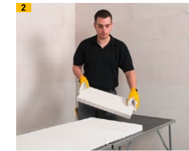
Zur schnellen Verarbeitung können mehrere Multipor WI compact plus Platten nebeneinander gelegt werden
